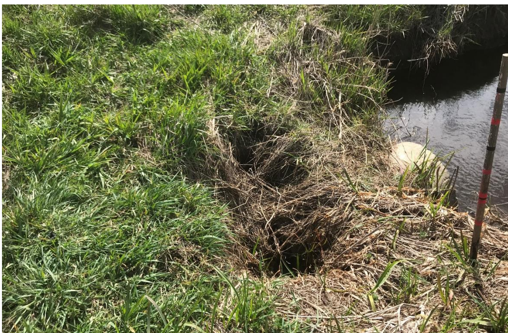
Figur 4. Forskudt rør i indløbet af rørlægningen i st. 593– 2.532 m.
